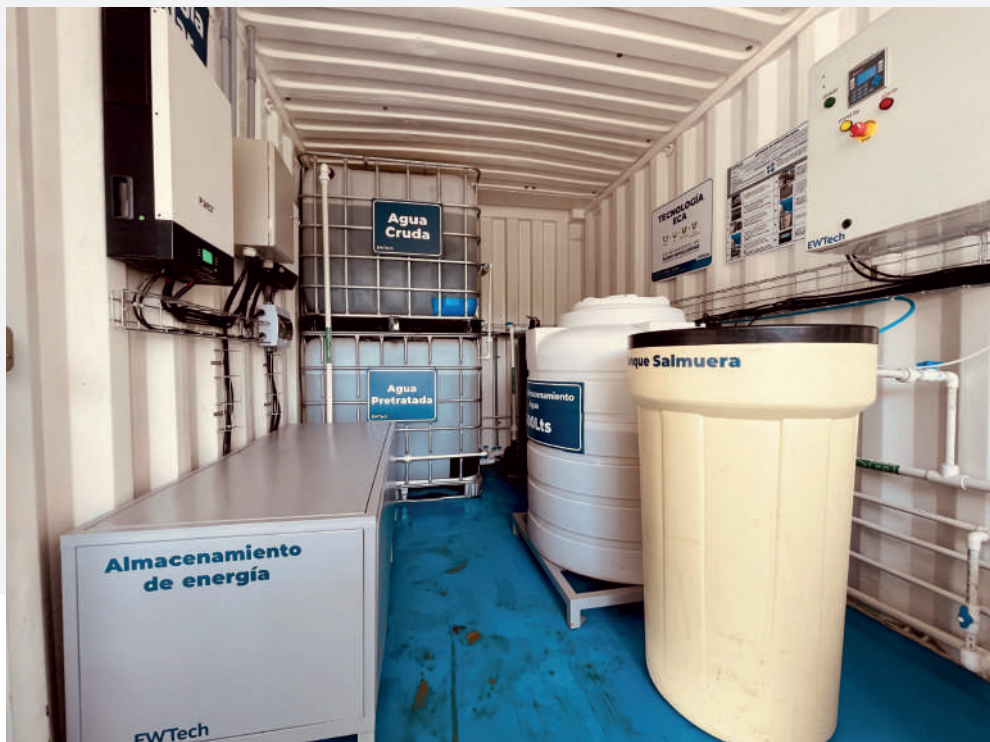
Sistema Filtracion y Sistema de Energia Solar
